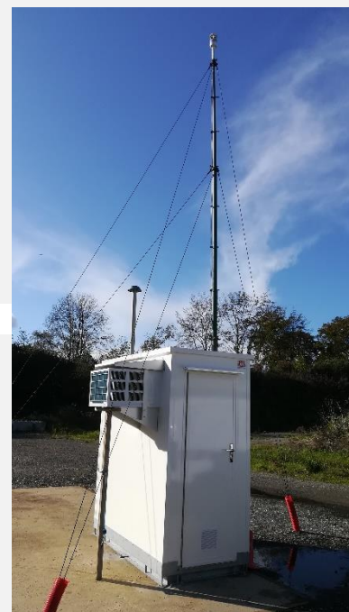
Station pérenne sur le site de traitement
